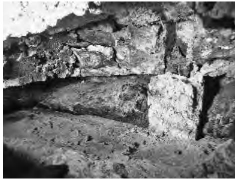
Abb. 23: Müstair, Kloster St. Johann. Karolingischer Horizontalbalken in der östlichen Giebelspitze mit einer Aussparung, darin eingemauert ein vertikales Pföstchen, das vermutlich der Bauvermessung diente. Der Balken ist 775/76 n. Chr. gefällt worden.
